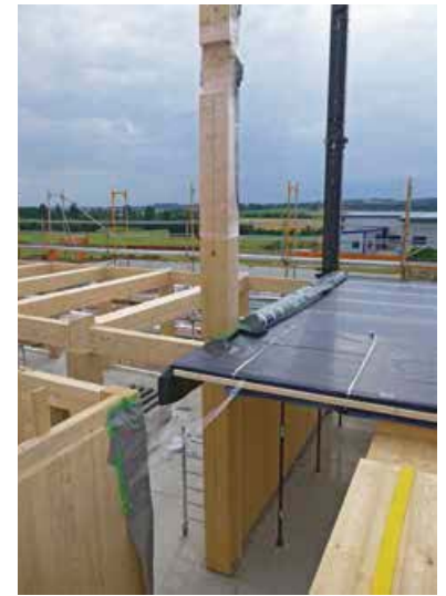
▶ Die BSP-Deckenelemente werden an den Stützen vorbei auf den Unterzügen verlegt. Die Folie schützt vor Feuchtigkeit
