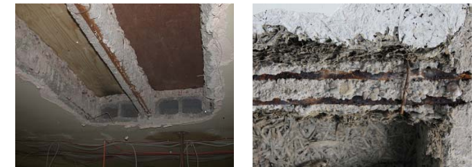
Bild 4: Schädigungen infolge mangelhafter Bauausführung
